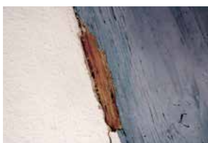
Vorstehende Putzkante: die ungünstige Wasserführung erleichtert das Eindringen von Feuchtigkeit
