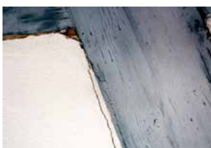
Putz wurde nicht mit einem feinen Messerschnitt vom Holz getrennt
